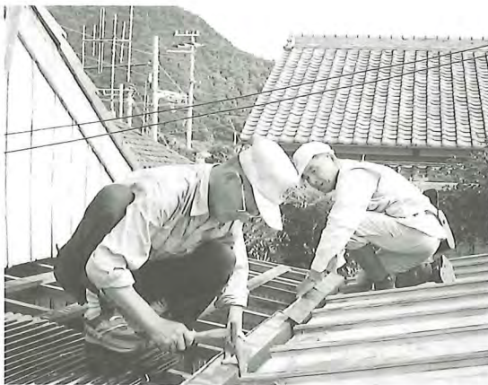
屋根の修理をしているところです。 元大工の会員さんが作業しています。
